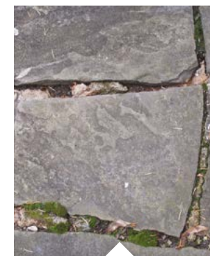
Spoiny z zaprawy murarskiej mogą pękać i gnić
